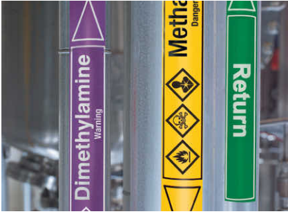
Kennzeichnung von Rohren und Ventilen
