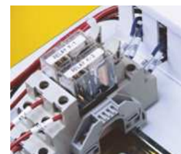
Etiketten für Komponenten in Schaltschränken
